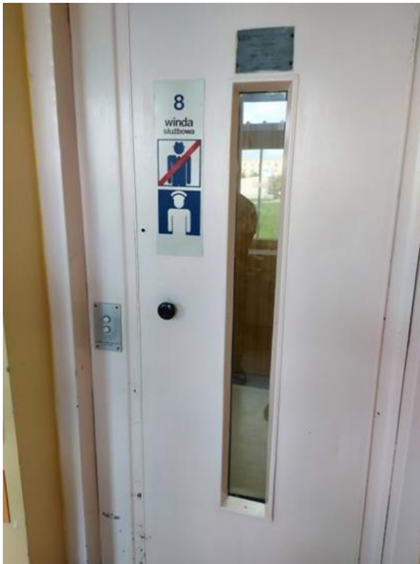
Fot. 8. Winda do wymiany – zbyt wąskie drzwi
