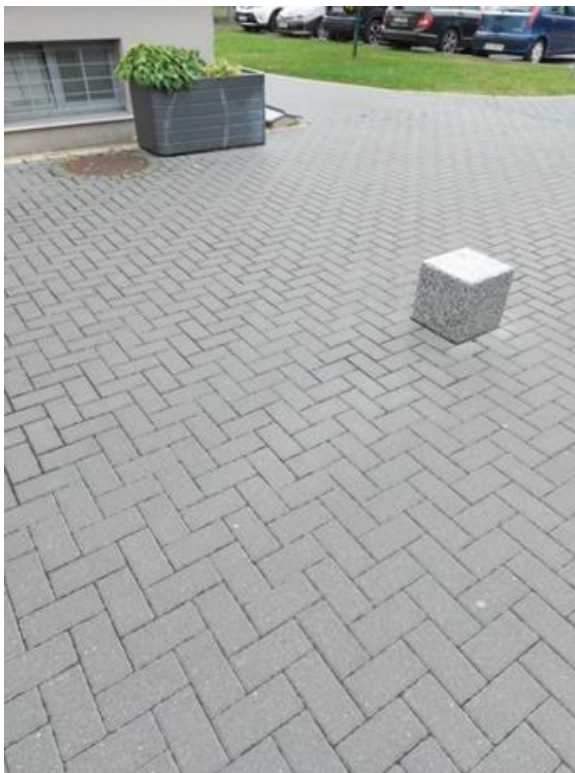
Fot. 3. Niskontrastowane słupki
