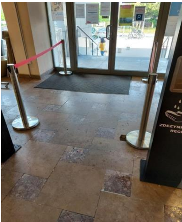
Fot. 4. Wejście do szpitala wymagające przebudowy
