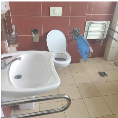
Zdjęcie nr 5: Toaleta
