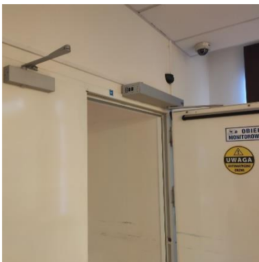
Zdjęcie nr 3: Drzwi wewnętrzne siłowniki
