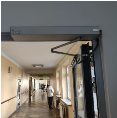
Zdjęcie nr 2: Drzwi wewnętrzne siłowniki
